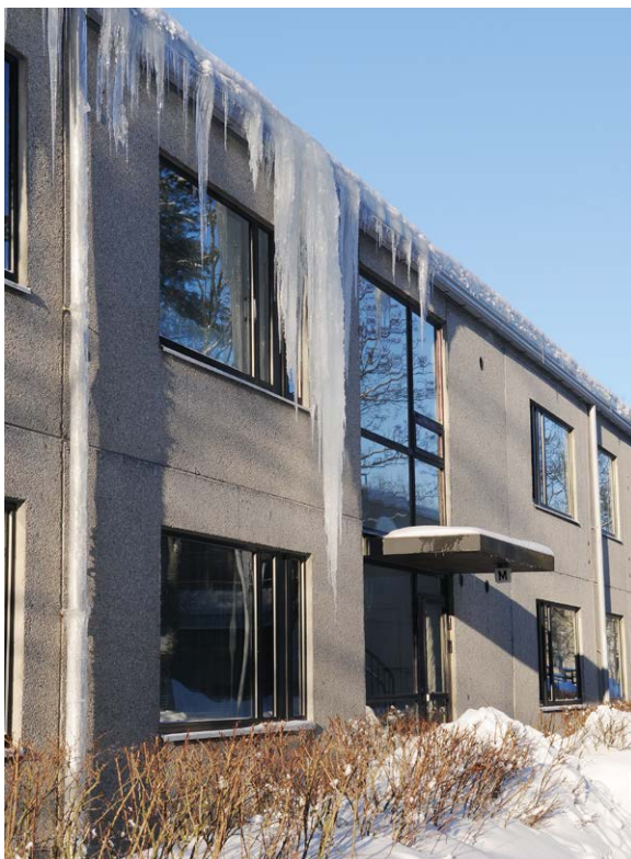
Jääpuikot kielivät usein yläpohjan lämpövuodoista. Olisiko taloyhtiön energiakokous paikallaan?
